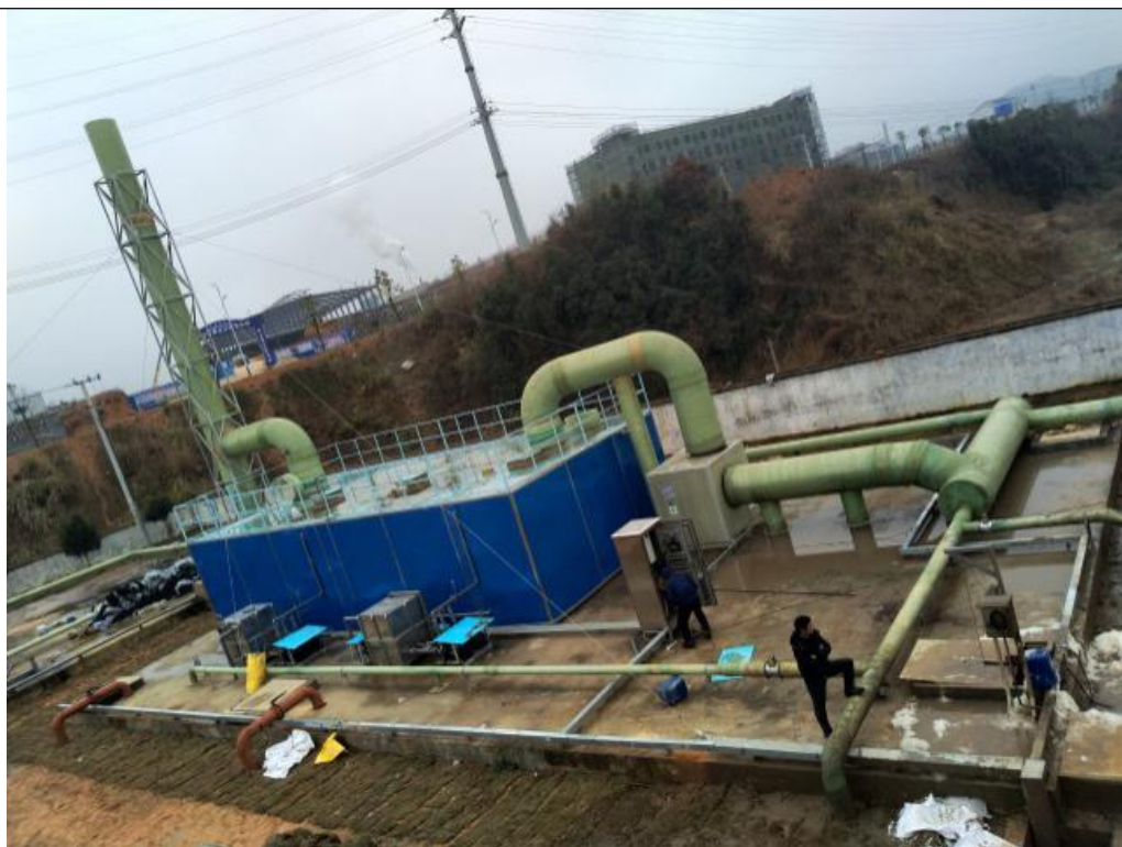
二期工程废气处理设施
