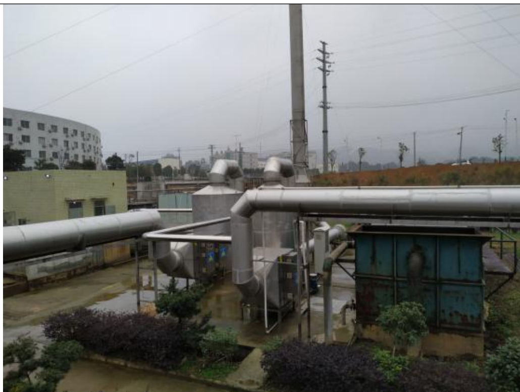
一期工程废气处理设施
