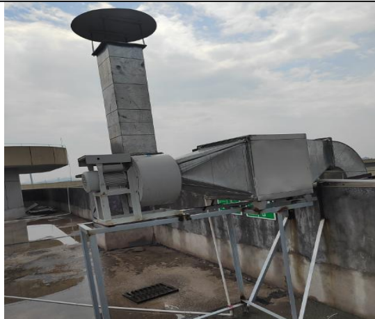
楼顶油烟净化器+排气筒现状
