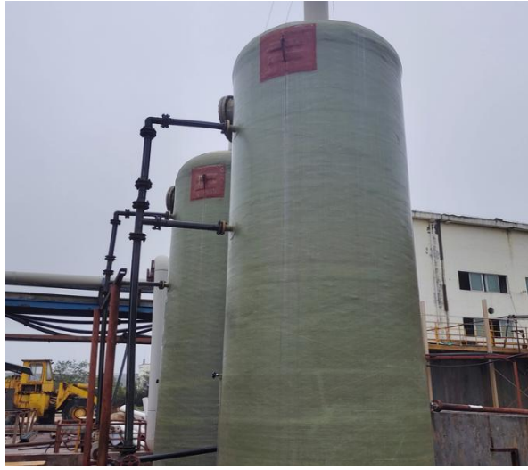
图 5 氰渣因科法反应槽尾气喷淋装置
