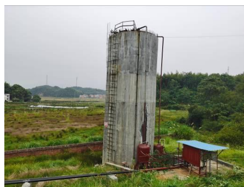
渣场渗滤液收集井
