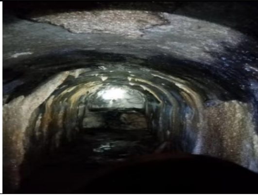
输水涵洞裂缝
