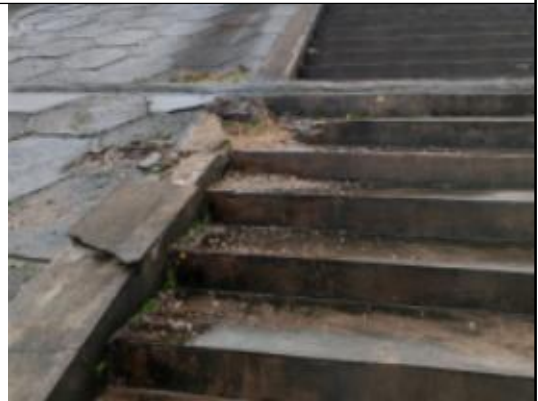
坝坡踏步破损
