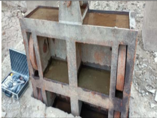
溢洪道泄槽闸门老化
