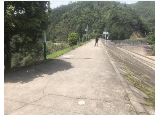
坝顶道路裂隙
