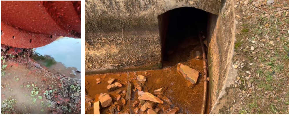
图 3.4 涵管出口渗漏现场照片
